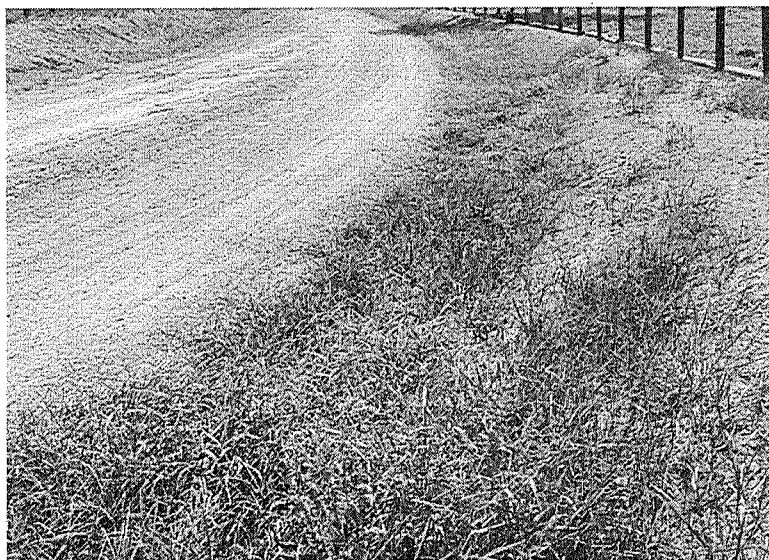
Fotografía No.1. Estado vía acutal
