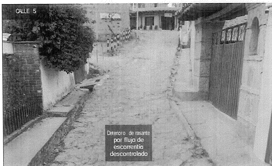
Imagen: Estado de las vías
